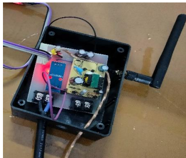
Gambar 3. Perangkat monitoring daya listrik Air Conditioner (AC)
