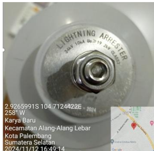
Gambar 3. Lightning arrester penyulang Arjuna
