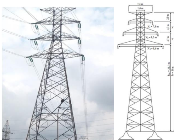
Gambar 4. Menara Saluran Transmisi Sirkuit Ganda 150 kV Gardu Induk Keramasan Palembang ke Gardu Induk Mariana
