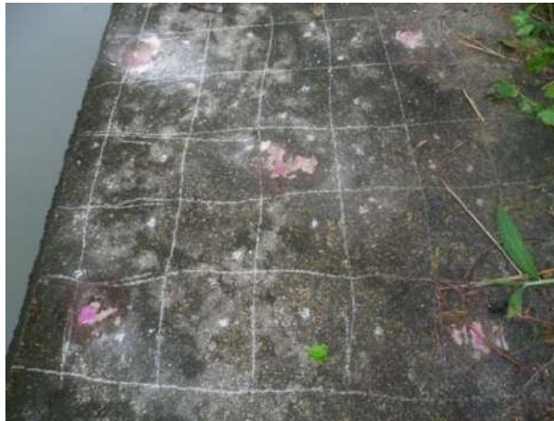
Gambar 20. Pengujian Karbonasi di Bottom Outlet – Spot 2
