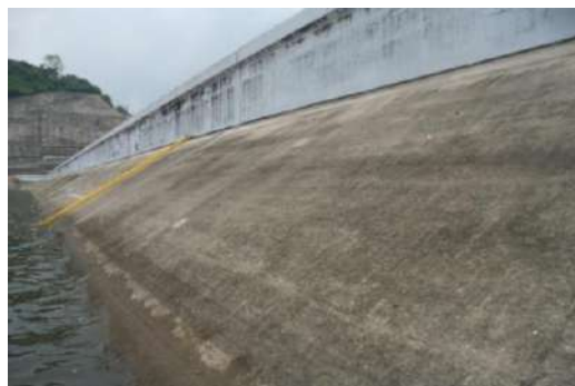
Gambar 10. Pengamatan Visual pada Concrete Faced dan Paraphet
