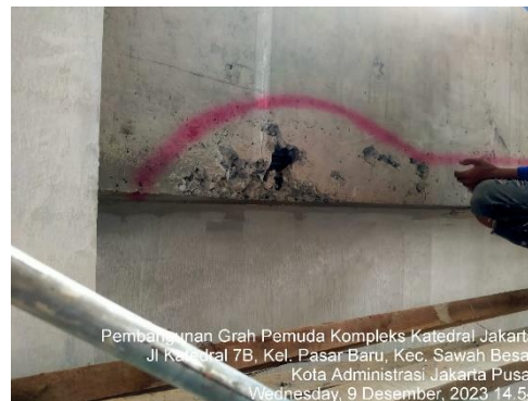
Gambar 5. Balok Segregasi dan Keropos
