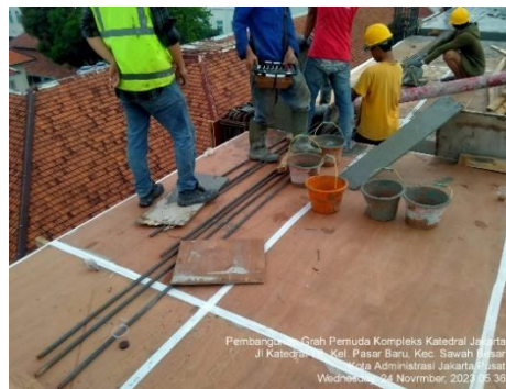
Gambar 12. Masalah Vibrator Beton yang Susah Masuk
