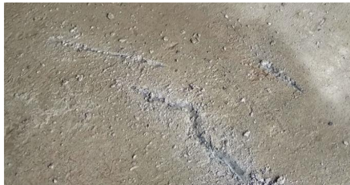
Gambar 4. Keretakan pada Pelat Lantai 2
