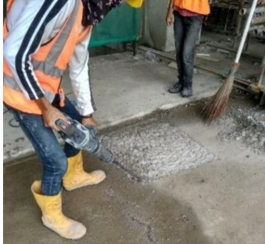
Gambar 5. Pembobokan Area Keretakan
