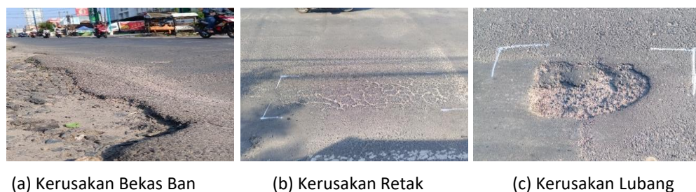
Gambar. 2 Kerusakan Jalan Pada Ruas Jalan
