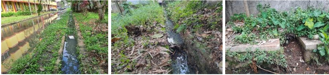
Gambar 5. Saluran Drainase Yang Tersumbat Di Kampus UNKRIS
