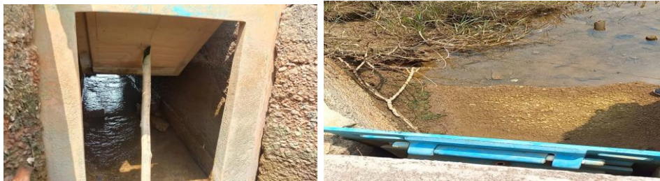
Gambar 5. Pintu air (Sumber: Dokumen Pribadi)
