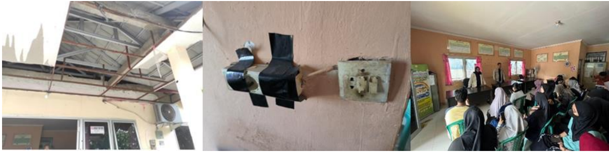
Gambar 3. Gambar kondisi awal instalasi listrik kantor Lurah 29 Ilir
