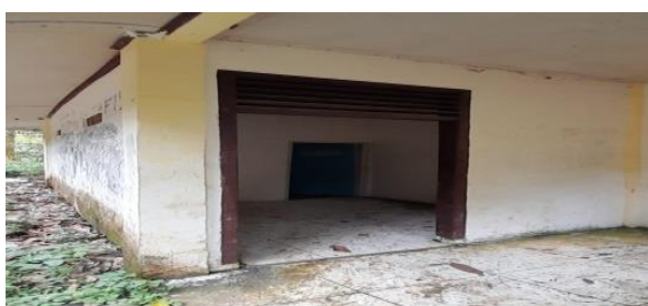
Gambar 5. Fasilitas-Fasilitas Yang Sudah Rusak
