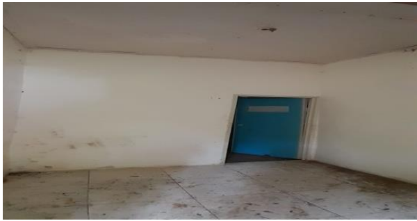
Gambar 7. Kondisi Wc dan Tempat Wudhu Curup Maung
